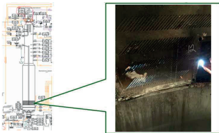
Рис. 7. Состояние сит отбора варочного котла после 7 месяцев работы без останова на чистку
